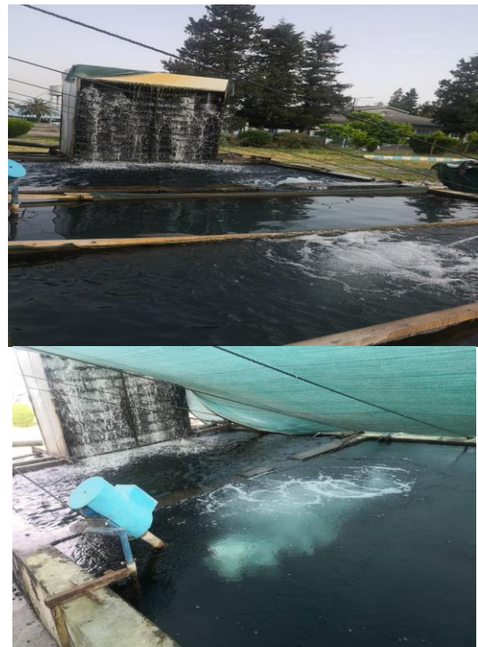
هوادهی آب ورودی (آب چاه) از طریق برج هوادهی
